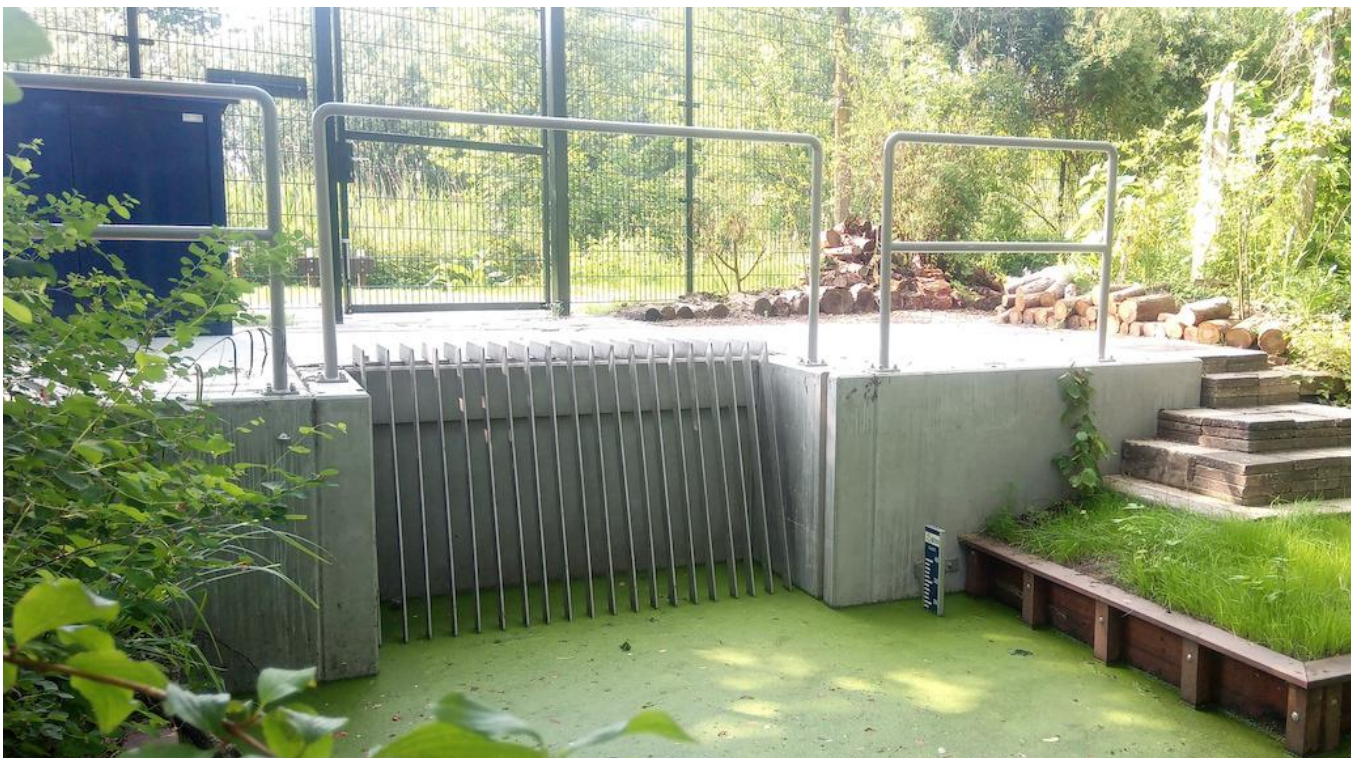
het nieuwe gemaal
